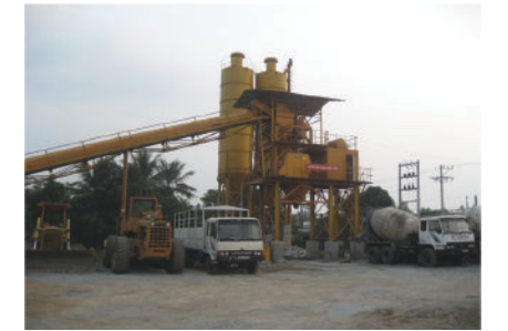
混凝土搅拌站
