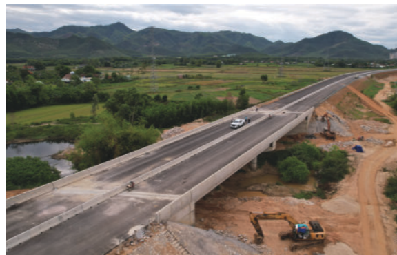
XL2号标段：施工07座公路桥， 属于万宁-甘露高速公路子项目
