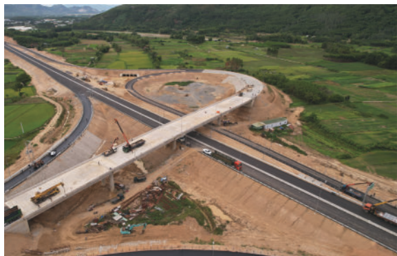
11-XL号标段：施工07座公路桥 属于归仁-至诚高速公路子项目
