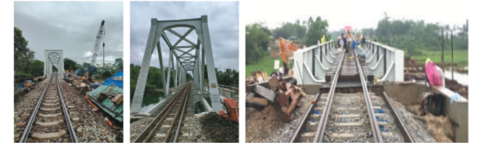
施工XL-CY-07标段各桥梁：施工从承天顺化省（681+884公里处桥梁）到广义省（939+419公里处桥梁）辖区内的13座桥梁
