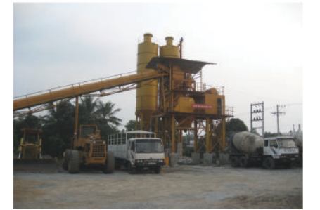
Trạm trộn bê tông tươi
