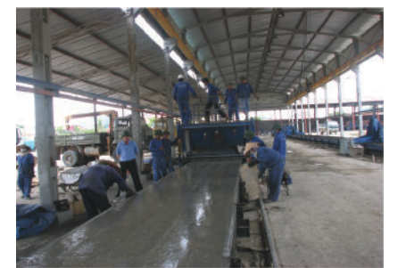
Nhà máy sản xuất tà vẹt và cấu kiện bê tông cốt thép tại Nghệ An
